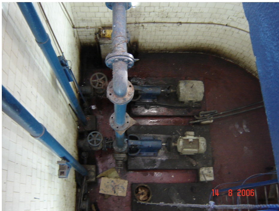
Figura 7. Visão panorâmica da casa de bombas da EEE-D6.
