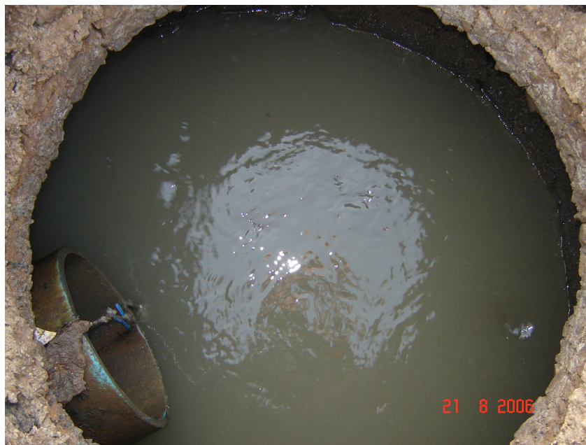
Figura 5. Poço de visita na esquina das ruas Juvino Barreto com São Tomé. Sistema funcionando precariamente.
