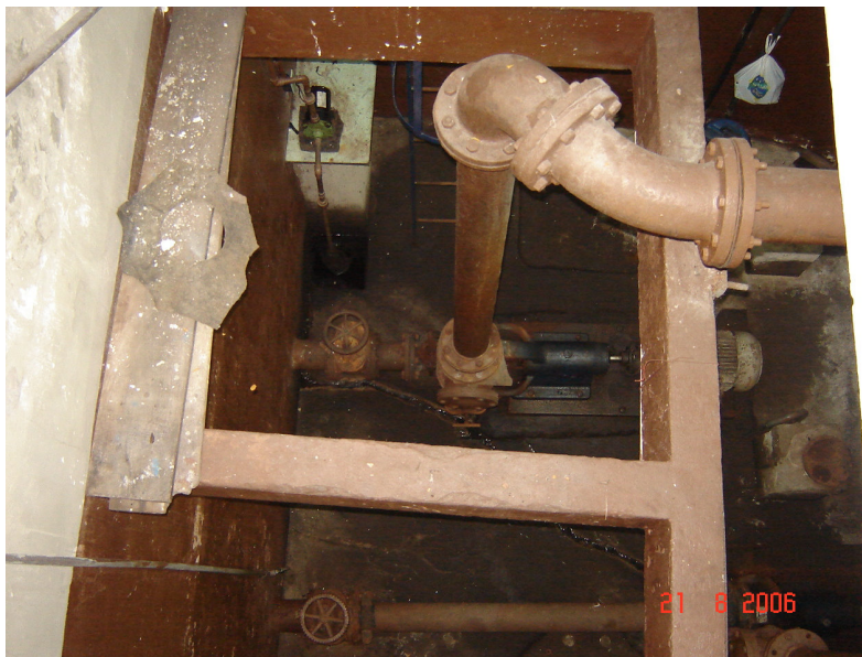
Figura 2. Visão panorâmica da Casa de Bombas da EEE-D5
