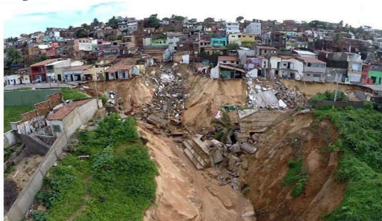
Figura 02 - Cratera do deslizamento de terra em Mãe Luiza.
