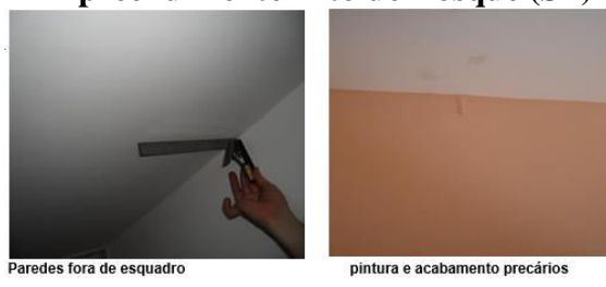
Figura 5 – Problemas nas paredes Empreendimento Alto do Bosque (SP)
