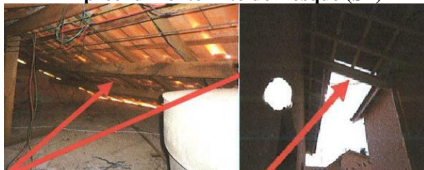
Figura 6 – Problemas no telhado Empreendimento Alto do Bosque (SP)
